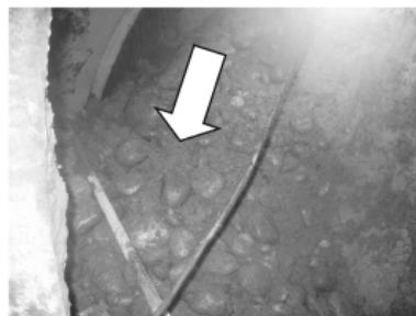
图6 挖面前方松散土体脱落照片
